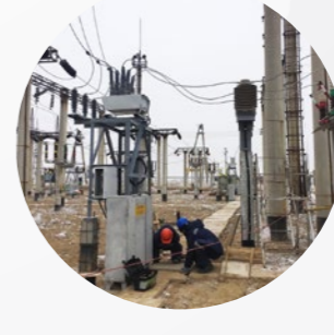
INTERRUPTOR DE SUBESTACIÓN
