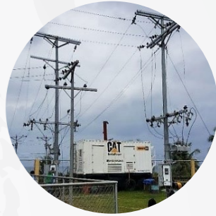
CONEXIÓN A GENERADORES
